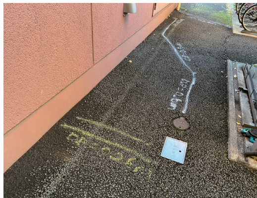
上水道管 VP13 管路追跡
